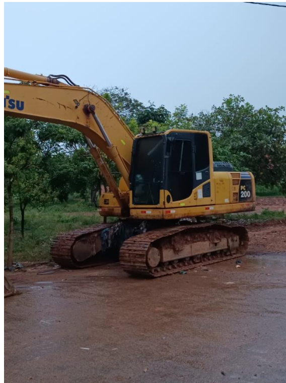
FIGURA 23 - EQUIPAMENTO ATERRO SANITÁRIO
